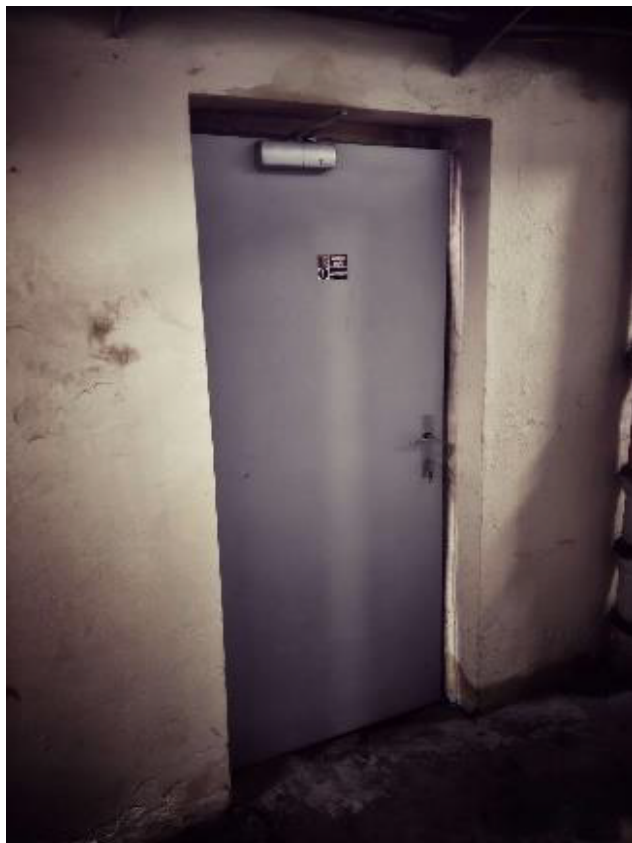
Požární dveře po požáru
